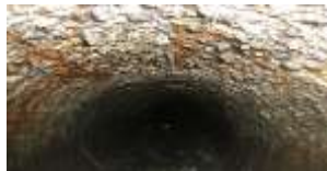
劣化が進んだヒューム管
