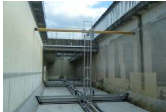
モノレール式汚泥かき寄せ機
