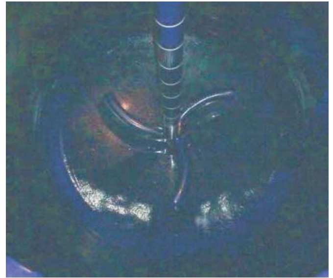
ធុងកញ្ចក់ដែលមានជាតិដែកខ្លាំង Aggressive corrosion Glass lining tank
