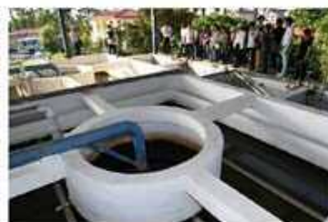
視察② ビンバオ浄水場 ハイフォン市水道公社が運営しているビンバオ浄水場にて、北九州市の技術であるU-BCFが導入されている説明を受けた。
