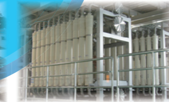
UF Membrane Facility
